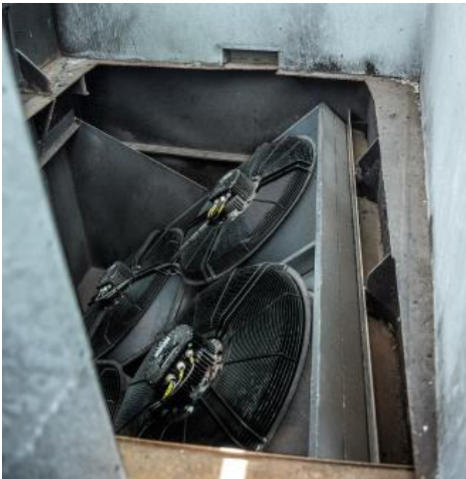
Bild 2: Die schwenkbare Metallplatte mit vier Ventilatoren sorgt für die energiesparende Belüftung des Autodecks.
